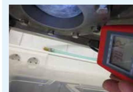
Abb. 39 a/b: Hydrostatischer Druckversuch nach 2 Jahren natürlicher Alterung unter Dacheindeckung; oben: mikroporöse Bahn undicht bei Wassersäule von < 0,6 cm; unten: die SOLITEX MENTO 3000 erreicht Werte > 3 m
