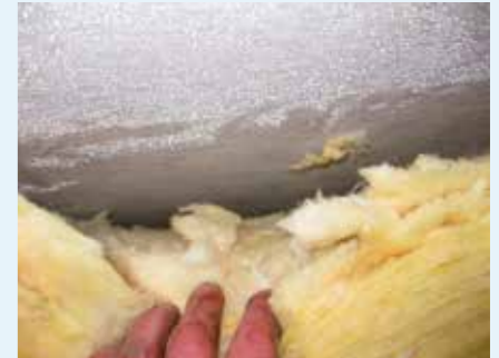
Abb. 30: Wasserfilmbildung bei mikroporöser Unterdeckbahn.
